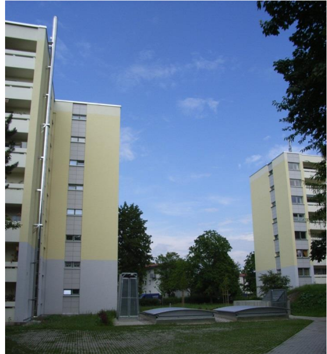
unterirdische Heizzentrale mit Brennstoffsilo sichtbar: Kamin, Flaschenzug für Aschentonnen, Silo-Einfüllöffnungen
