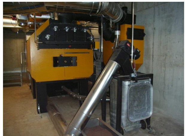
Biomasse-Feuerung mit Aschenaustragung und Abgasreinigung
