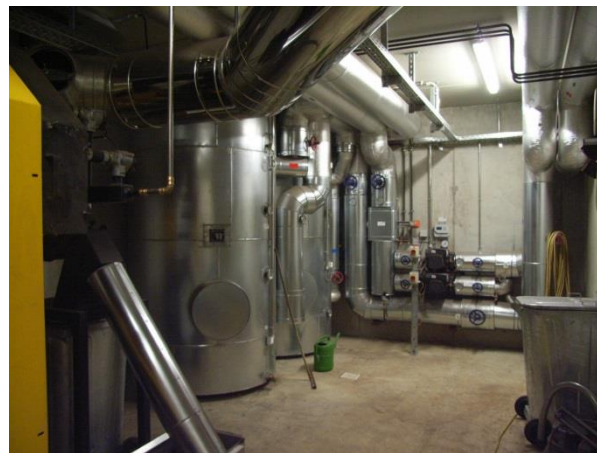
Pufferspeicheranlage und Netzpumpen
