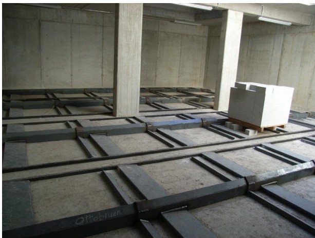
Brennstoffsilos mit Schubboden-Raumaustragung
